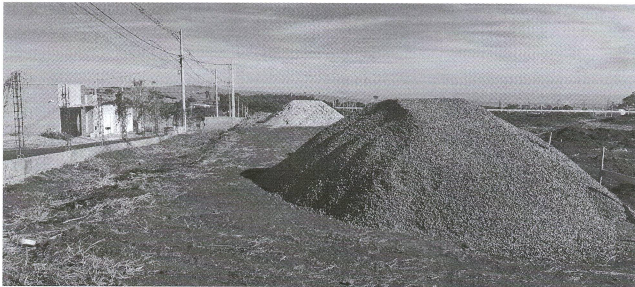
Foto 07 - Referente aos serviços de gabarito da obra e a escavação para realização das vigas baldrames.
