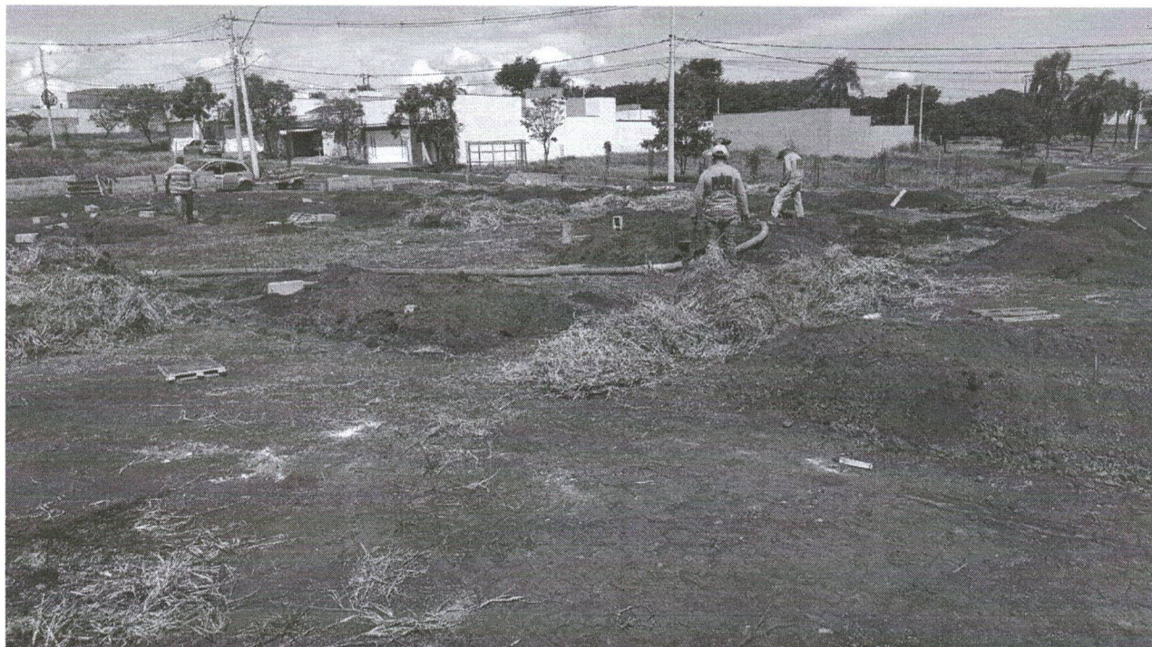
Foto 02 - Referente aos serviços de concretagem das estacas armadas escavadas com profundidades variando entre 7,5 metros e 13 metros de profundidade, com diâmetros variando de 0,30 m a 0,50 m.
