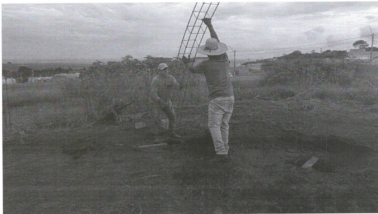
Foto 06 - Referente aos serviços de concretagem das estacas armadas escavadas com profundidades variando entre 7,5 metros e 13 metros de profundidade, com diâmetros variando de 0,30 m a 0,50 m.
