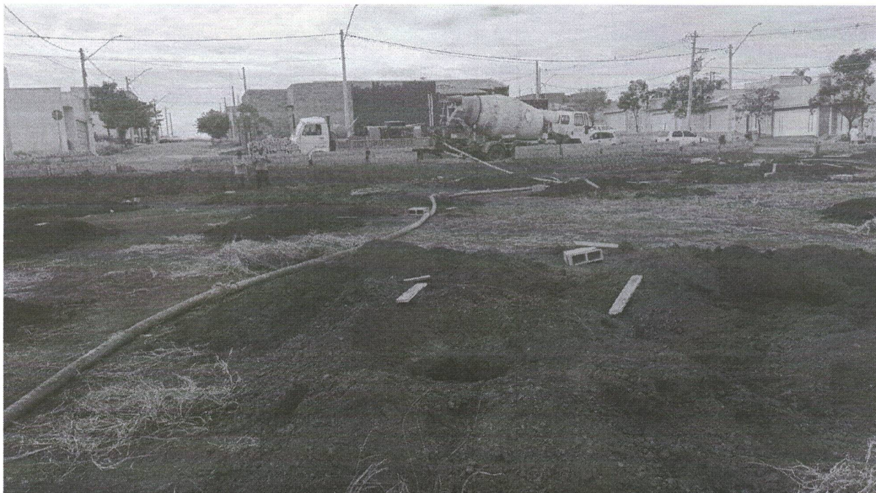
Foto 04 - Referente aos serviços de concretagem das estacas armadas escavadas com profundidades variando entre 7,5 metros e 13 metros de profundidade, com diâmetros variando de 0,30 m a 0,50 m.
